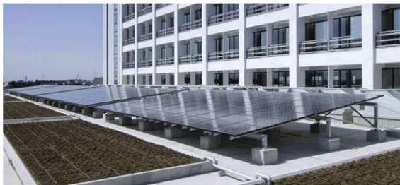
太陽光発電パネル（つくば市庁舎）
