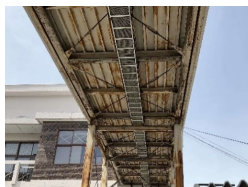
屋外に露出した配線
