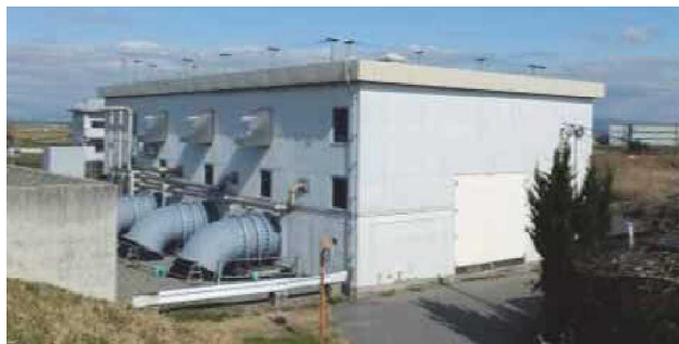
山ノ井〔上流〕排水機場
