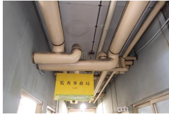
【老朽化したむき出しの設備配管】
