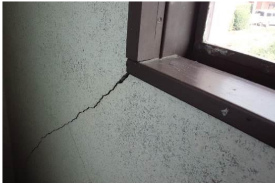
【クラック（ひび割れ）が発生している様子】
