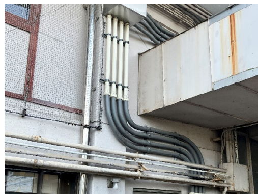
屋外に露出した電気配線
