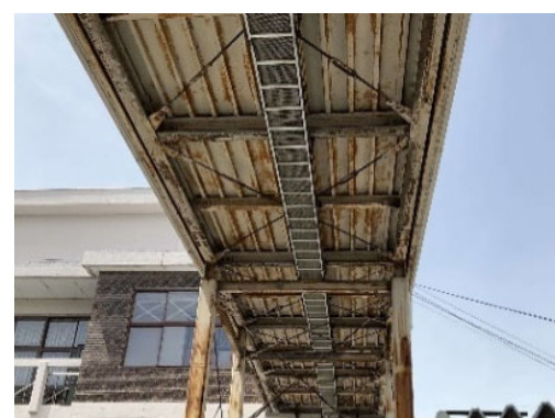
屋外に露出した配線
