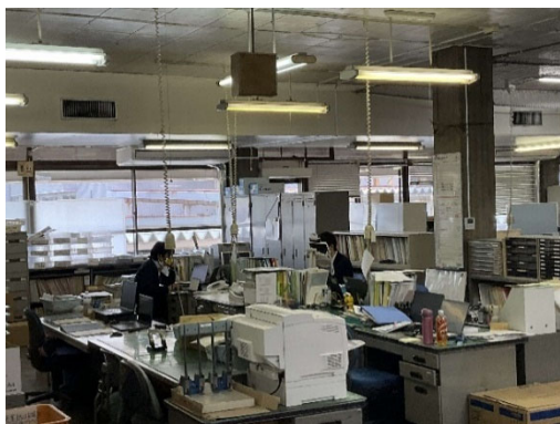
天井から吊り下がるコンセント配線
