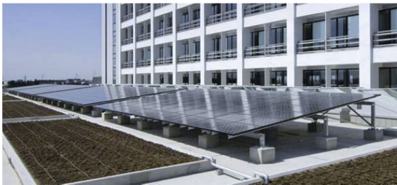
太陽光発電パネル（つくば市庁舎）
