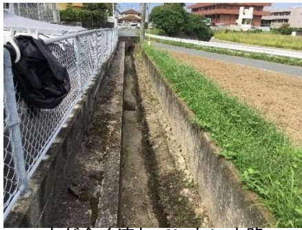
水が全く流れていない水路
