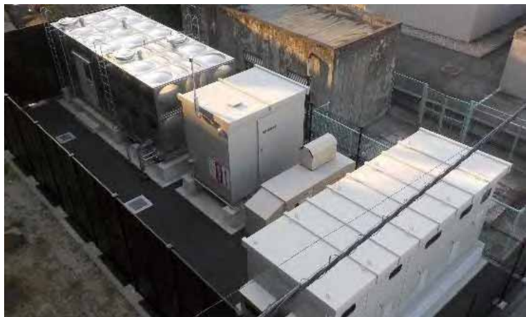
▲中庭に移転・嵩上げた受変電設備等
