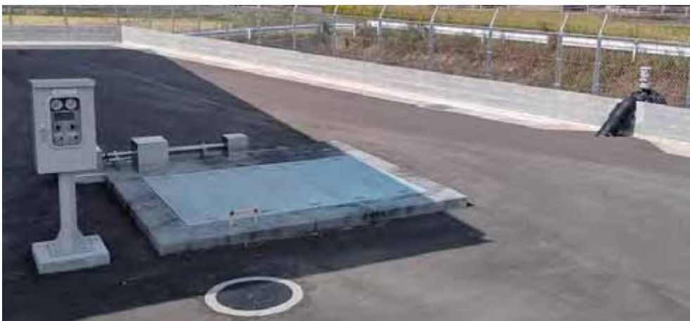
▲新設された強制排水設備
