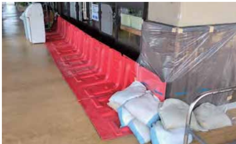
▲雨水の侵入を防ぐ簡易型止水板
