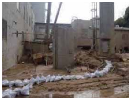
▲土砂流入による被害
