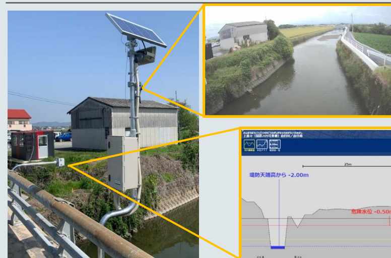
水位計と監視カメラの設置状況と、インターネットからの閲覧イメージ
