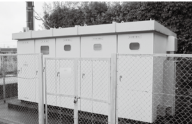
移設・更新を待つキュービクル
