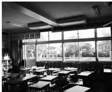
デマンドコントローラー(右) 教室のエアコン(左) (羽犬塚小学校)
