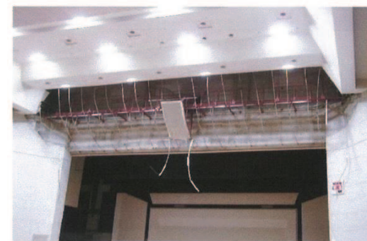
《崩落した天井》※他自治体事例
