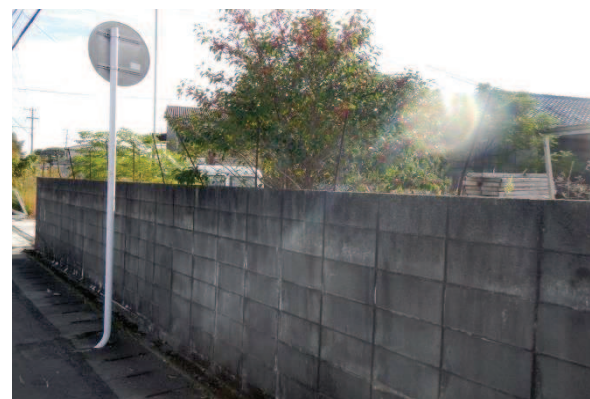
《通学路沿いのブロック塀》
