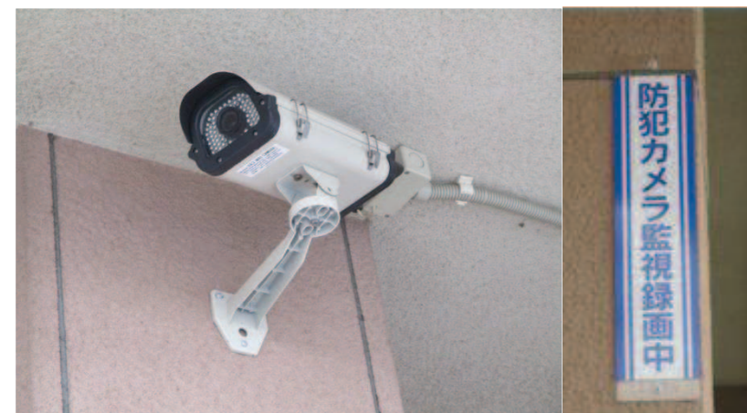
《防犯カメラの設置及び表示例》
