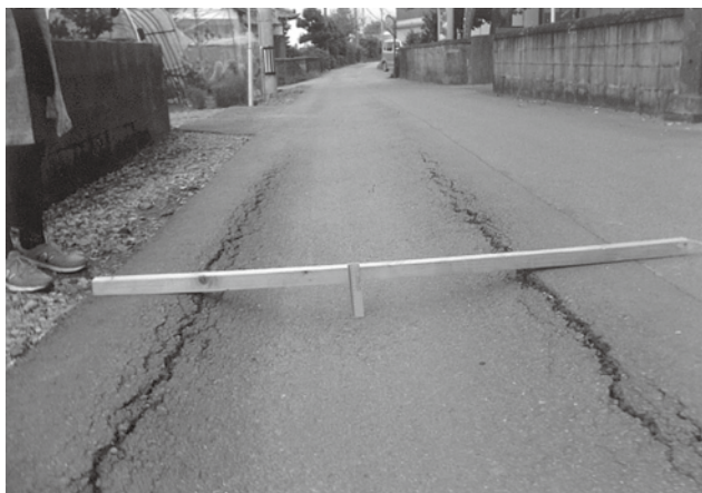
施工不良で11センチも陥没した市道
