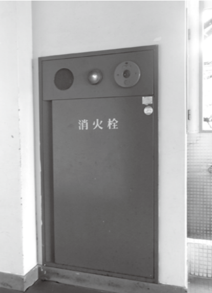
老朽化した水田小学校の消火栓
