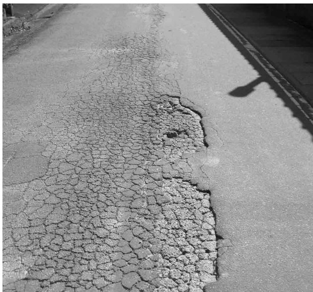
舗装道路の破損箇所
