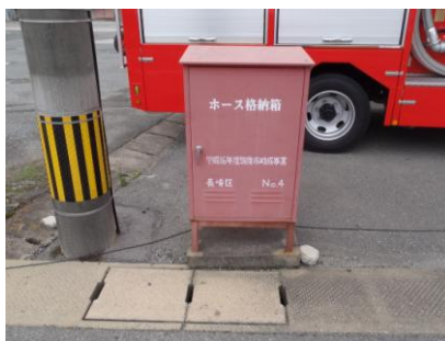
消火栓ボックス
