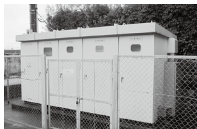
移設・更新を待つキュービクル
