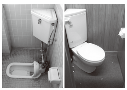
今後、体育館トイレの改修が急務
