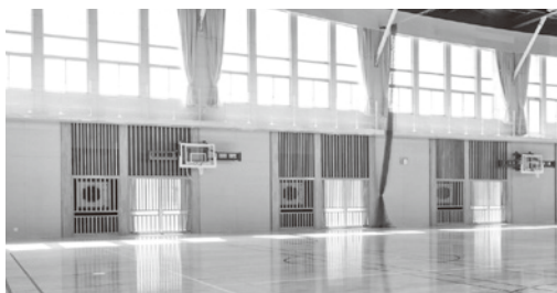
筑後南小学校体育館に設置されている空調設備
