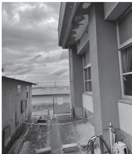
市内の多くの学校施設で老朽化が進んでいる
