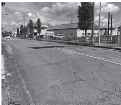
交通量が多い市道でも舗装補修が滞っている箇所がある (写真は筑后市立病院前)
